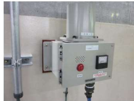
機器の固定状況
