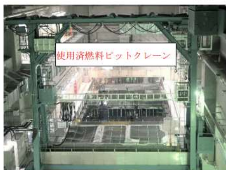
使用済燃料ピットクレーン
