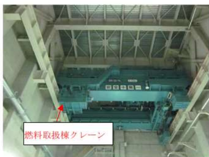
燃料取扱棟クレーン
