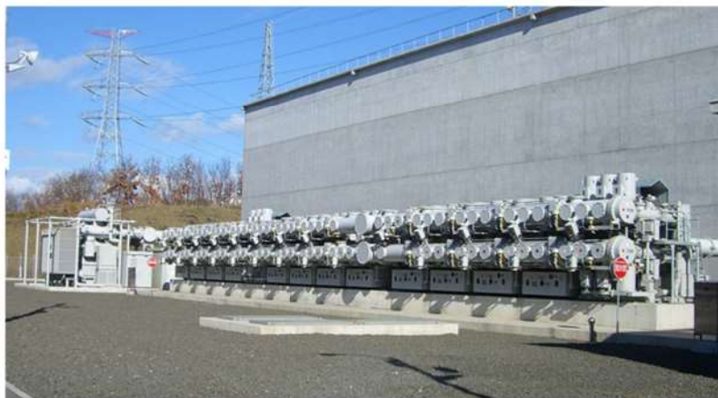
第 2.2.4.6 図 開閉所設備外観
