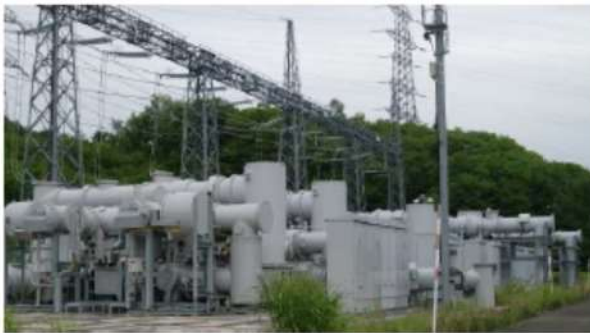
西野変電所（GIS）
