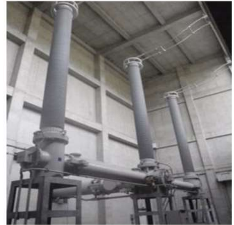
275kV ブッシング
