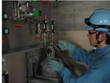
⑤窒素ガスポンベからの窒素供給操作 (ポンベロ金操作) 写真は、加圧器逃がし弁用窒素ガスポンベ
