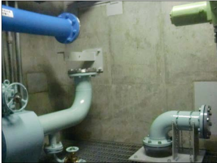
CCWS-SWSタイラインの全景 写真右下:スプールピース 写真左上:接続箇所)
