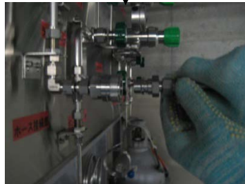
②窒素ガスポンベのカップラ接続前イメージ 写真は、加圧器逃がし弁用窒素ガスポンベ
