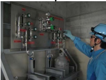
⑥窒素ガスポンベからの窒素供給操作 (バルブパネル操作) 写真は、加圧器逃がし弁用窒素ガスポンベ
