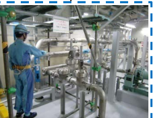
⑥燃料取替用水ポンプエリアへ(設置予定箇所)
