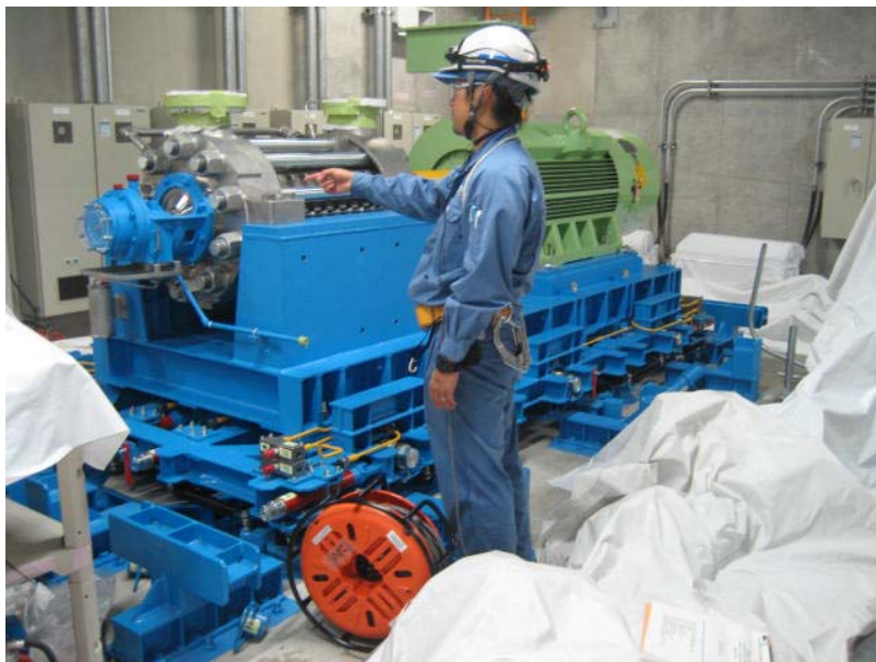
①代替格納容器スプレイポンプのイメージ 写真は、代替格納容器スプレイポンプと同様に 免震架台に設置されているSG直接給水ポンプ
