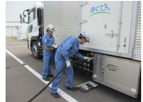
④代替非常用発電機燃料タンク へ給油ホースの接続
