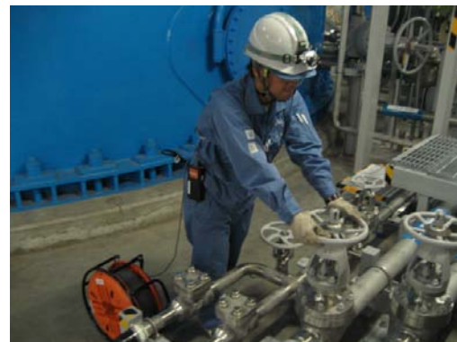
②代替格納容器スプレイポンプ注水系統構成のイメージ 写真は、代替格納容器スプレイポンプと同様に免震架 台に設置されているSG直接給水ポンプの注水系統構成
