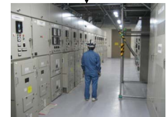
⑧安全補機開閉器室②
