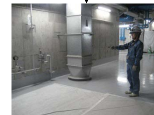
⑧代替格納容器スプレイポンプエリア(設置予定場所)
