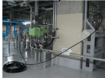
④窒素ガスポンベのホース接続イメージ 写真は、加圧器逃がし弁用窒素ガスポンベ
