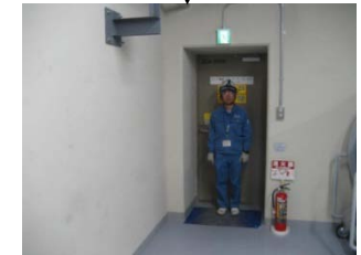
⑦安全補機開閉器室①
