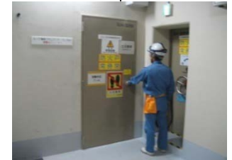
⑥安全補機開閉器室入口扉へ
