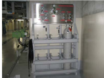
①窒素ガスポンベのイメージ 写真は、加圧器逃がし弁用窒素ガスポンベ
