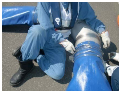
10m盤ホース接続部 (カップラタイプではない)
