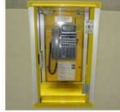
運転指令設備 (ハンドセットステーション)
