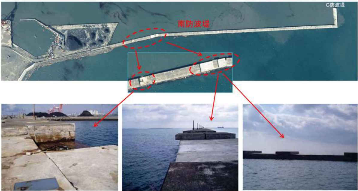
外港地区 南防波堤 (平成 23 年 3 月 23 日撮影⑤) 上部工 欠落
