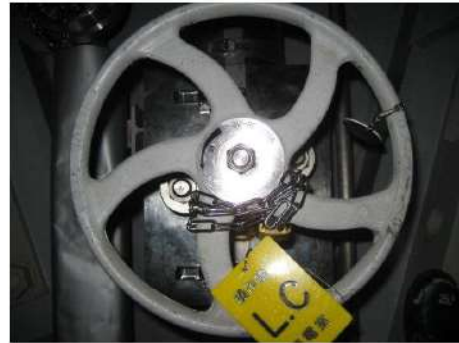
図2 弁施錠状態の例の写真
