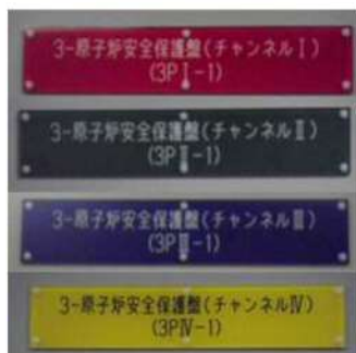
盤の識別 (原子炉安全保護盤の例)
