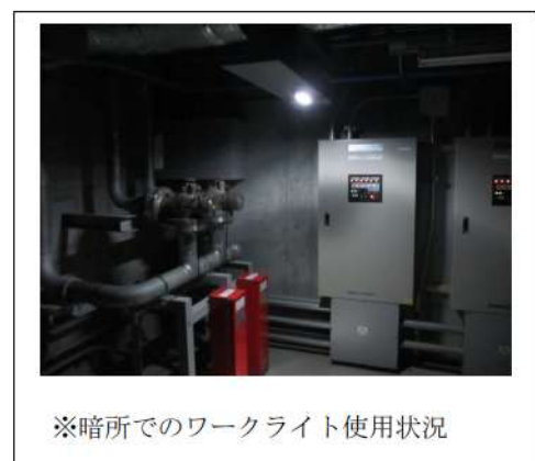
図4 可搬型照明の仕様及び使用状況
