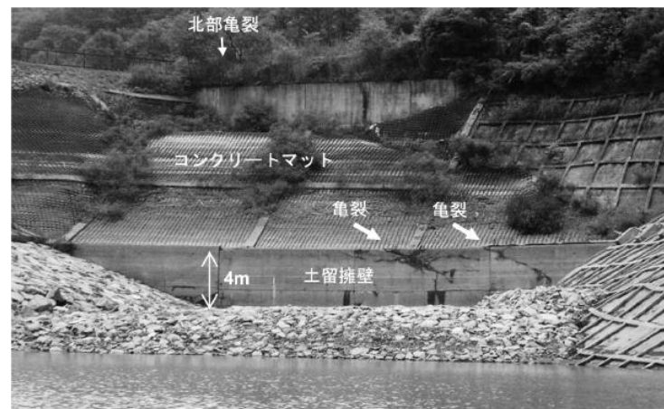
写真-2 土留擁壁への亀裂 右端のリップラップの盛り上がりは施工当時のもの。
