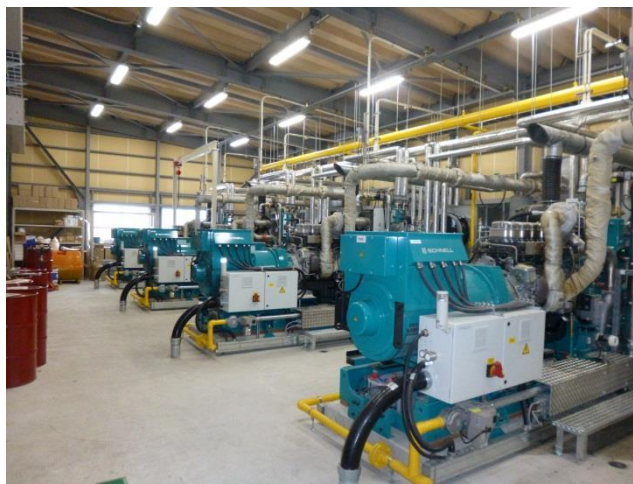
バイオマス発電機
