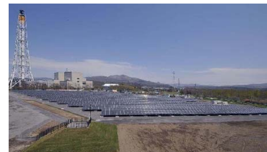
<伊達ソーラー発電所>
